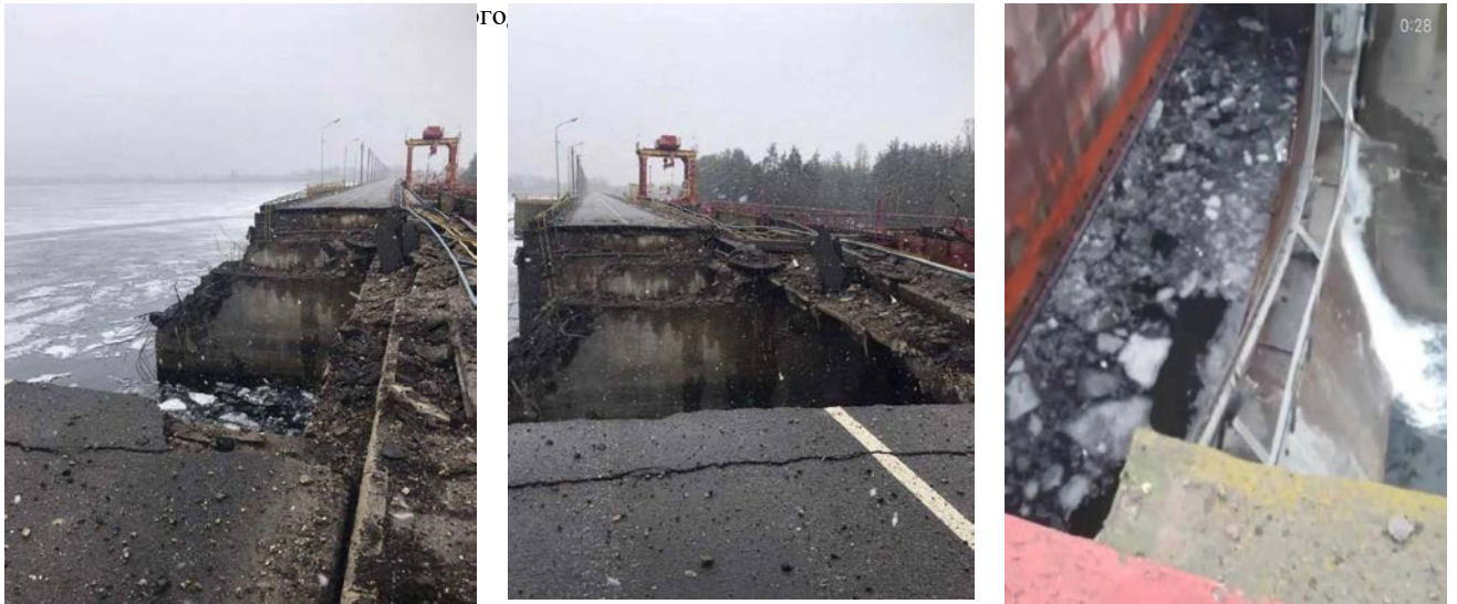
Рис.1. Руйнування частини Печенізького гідровузла внаслідок підриву
